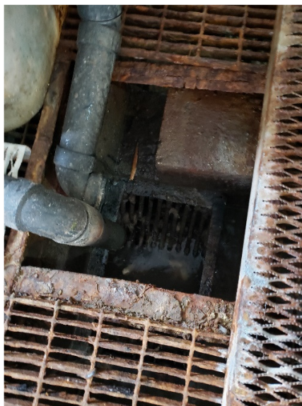
Figure 3 – Grille de protection manquante
